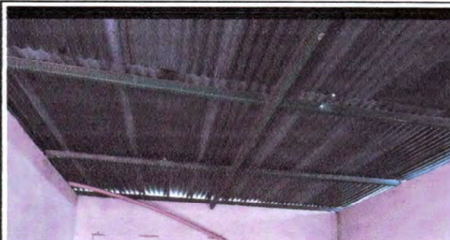
Foto 4: estructuras de metal con oxido y en mal estado salon No.3 con medidas de 6 metros de ancho por 10 metros de largo dando un total de 60 metros cuadrados
