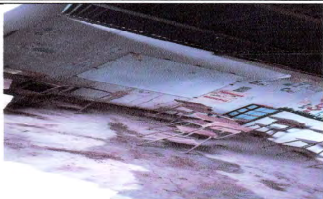
Foto 7: piso de cemento salon No.3 en mal estado con medidas de 6 metros de largo por 10 metros de ancho dando un total de 30 metros cuadrados
