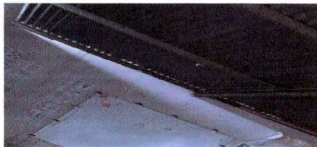
Foto 2: techo de lamina en mal estado salon No.2 Con medidas de 6 metros de ancho por 10 metros de largo dando un total de 60 metros cuadrados
