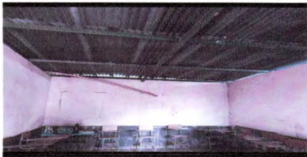
Foto 1: techo de lamina en mal estado salon No.2 con medidas de 6 metros de ancho por 10 metros de largo dando un total de 60 metros cuadrados
