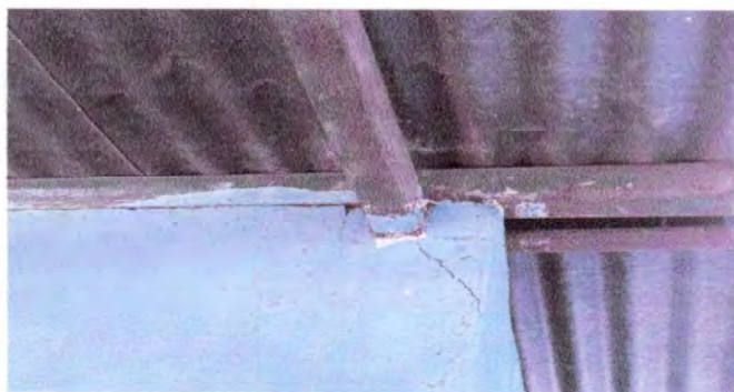
Foto 3: estructuras de metal con oxido y en mal estado salon No.2 con medidas de 6 metros de ancho por 10 metros de largo dando un total de 60 metros cuadrados
